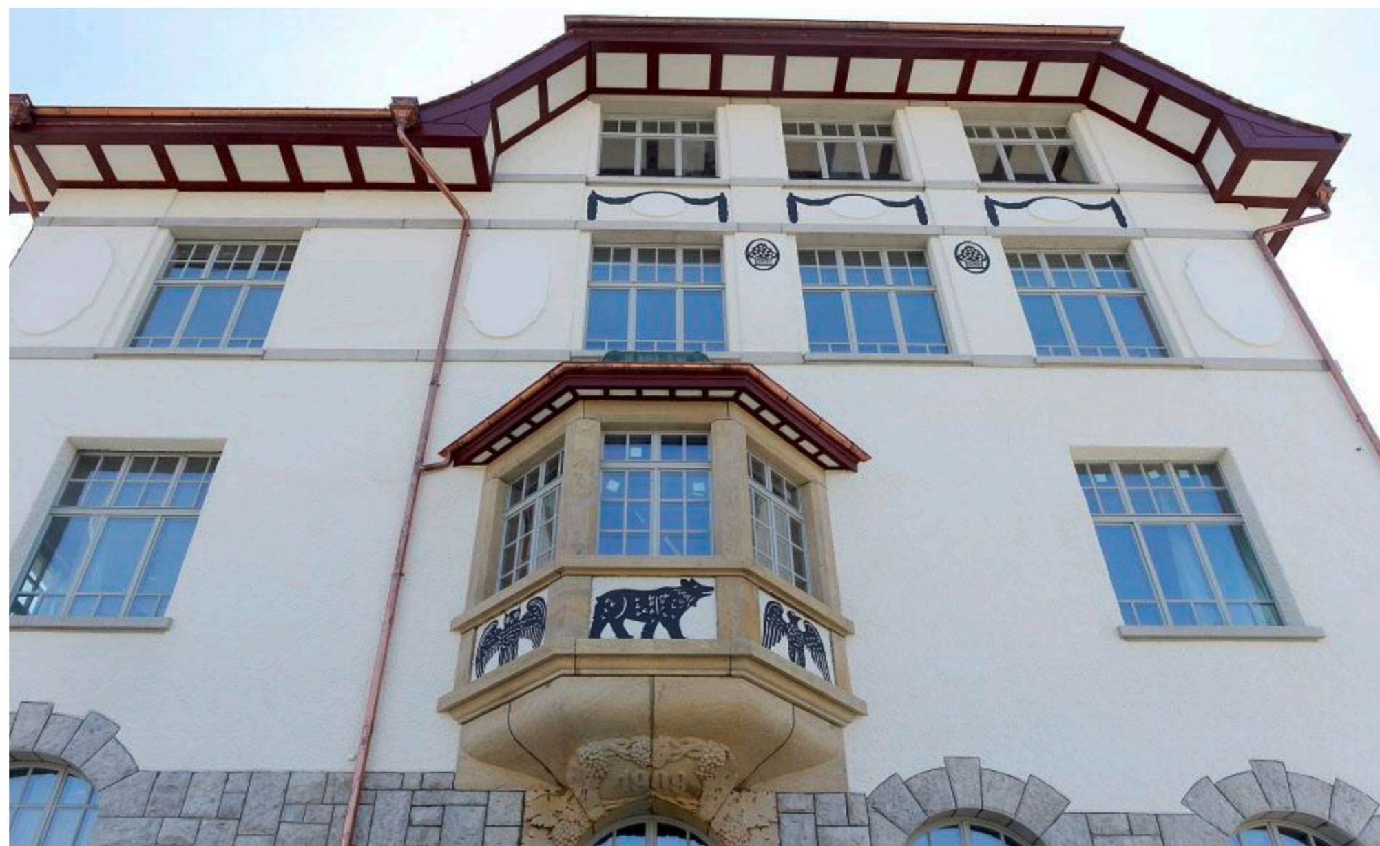
Reich verziert: Die sanierte Fassade des Pestalozzi-Schulhauses enthält verschiedene dekorative Elemente. Zum Beispiel (unten ist das Baujahr 1909 erkennbar), aber auch verschiedene Sgraffiti wie eine Eule, einen Bären, einen Adler (auf dem Ornamente (oben), welche rund ums ganze Schulhaus angebracht sind und nun allesamt mit Farbe aufgefrischt wurden.
