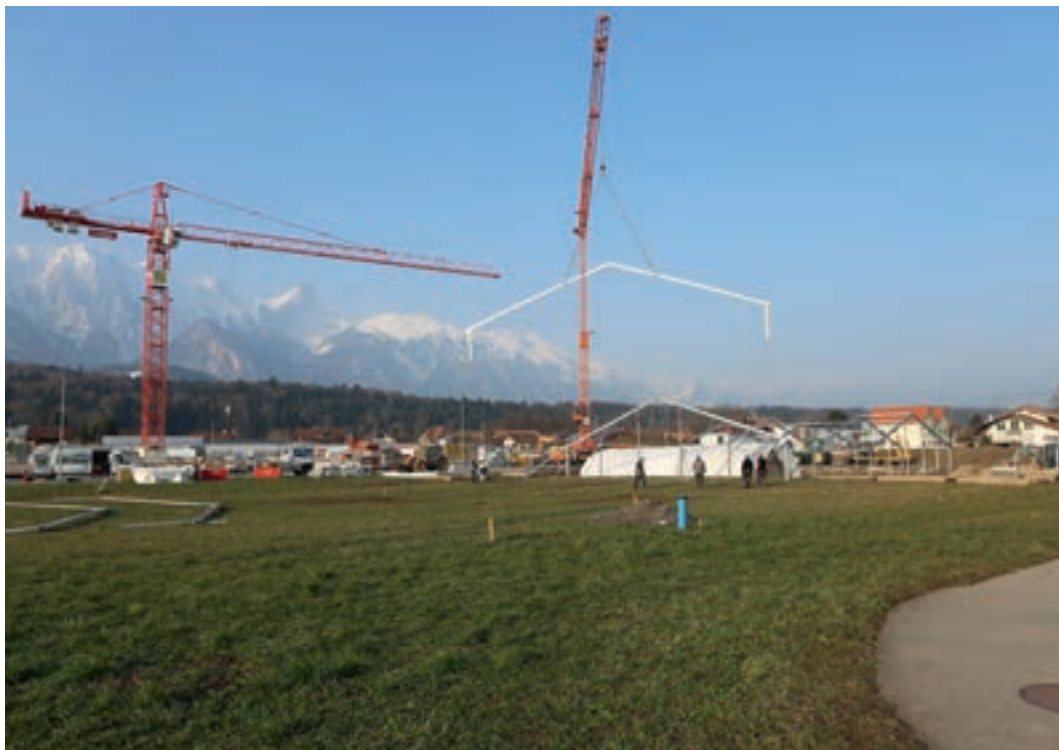
Abb. 1: Thun, Im Schoren 10. Nachdem die erste Teilfläche ausgegraben wurde, wird das Zelt umgestellt, damit auch bei winterlicher Witterung gearbeitet werden kann. Blick nach Osten.
