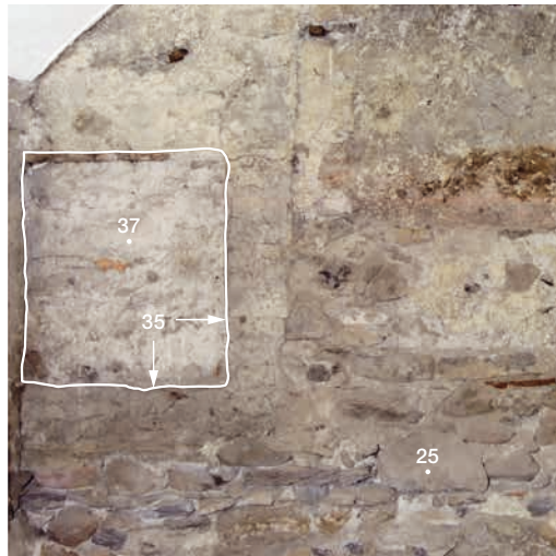
Abb. 3: Thun, Obere Hauptgasse 30. Südwestliche Wand des Gassengeschosses im Zustand vor der Sanierung im Dezember 2015. Der Ausschnitt zeigt die Fensteröffnung (35) der ehemaligen Fassade (25). Die Öffnung wurde später mit dem Mauerwerk (37) verschlossen.
