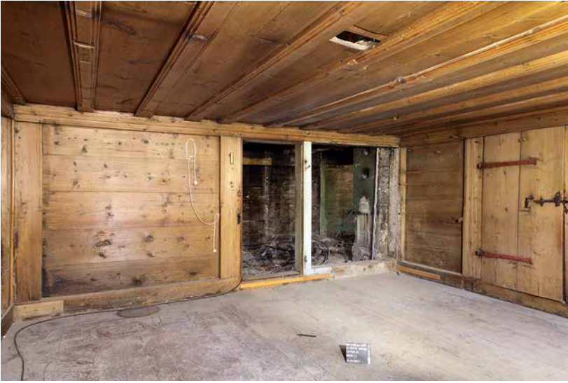
Abb. 3: Saanen-Gstaad, Litzistrasse 21. Die Stuben sind als Bohlen-Ständerkonstruktion errichtet. Alle vorkragenden Elemente sind durch eine Profilierung betont, die sich auch an den Balken der Decke finden. Blick nach Osten.
