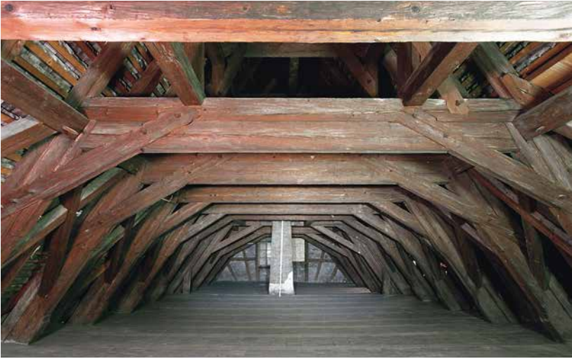
Abb. 6: Thun, Schloss. Mittlerer Abschnitt des südlichen Schlosstrakts, liegender Dachstuhl des Kernbaus von 1566/67. Blick nach Nordwesten.
