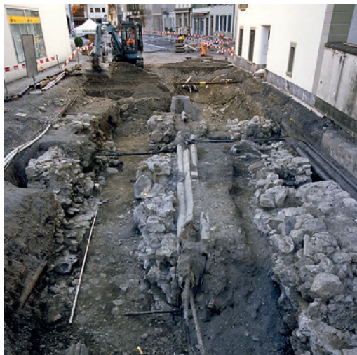
Abb. 4: Unterseen, Untere Gasse. Freigelegte Mauerzüge im Bereich des ehemaligen Thomattinentors und des zugehörigen Stadtgrabens. Blick nach Norden.
