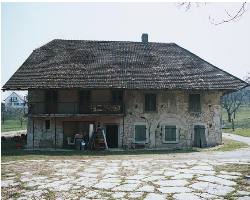
Abb. 1: Sutz-Lattrigen, Ziegelhütte. Der bauliche Zustand des alten Ländtehauses im Jahr 2007. Ansicht von Norden.
