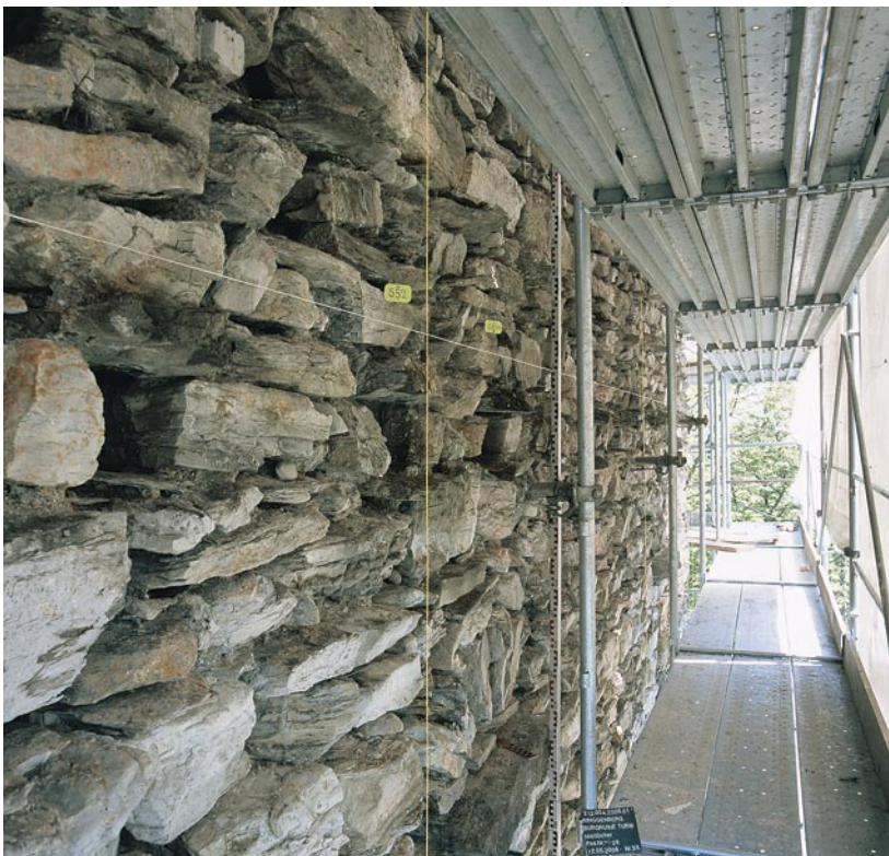
Abb. 4: Ringgenberg, Burg-ruine. Südfassade des Turms mit Brutnischen im noch unverputzten Zustand.
