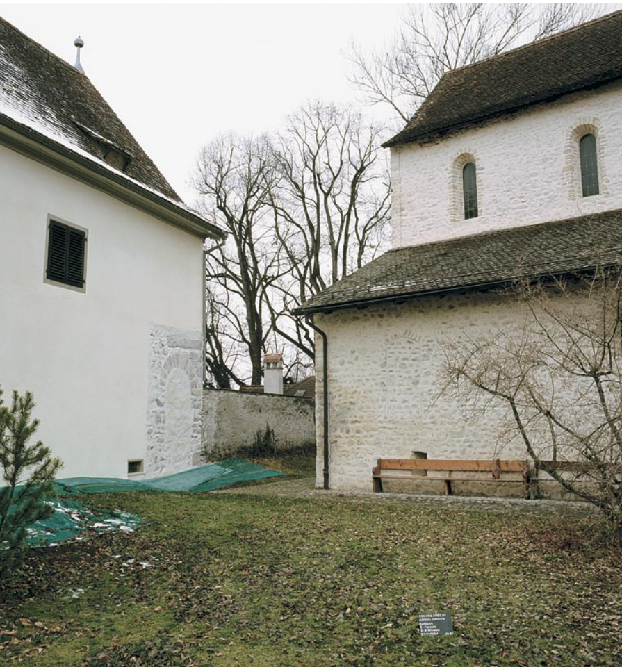
Abb. 1: Schloss Amsoldingen. Die frisch restaurierte Ostfassade mit dem zugemauerten romanischen Eingangsportal. Rechts die frühromanische Stiftskirche.
